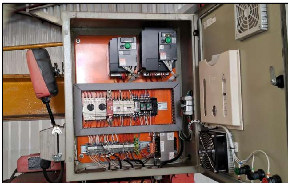
Figura 597: Painel elétrico da talha
