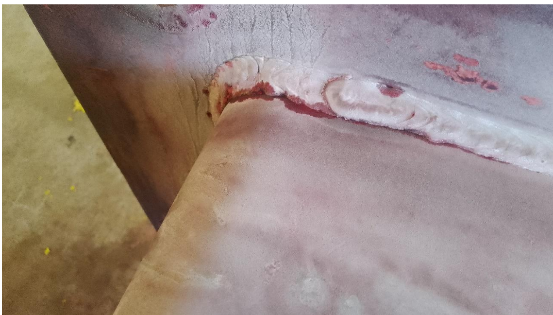
Resultado constatou as trincas e fissuras no cordão de solda
