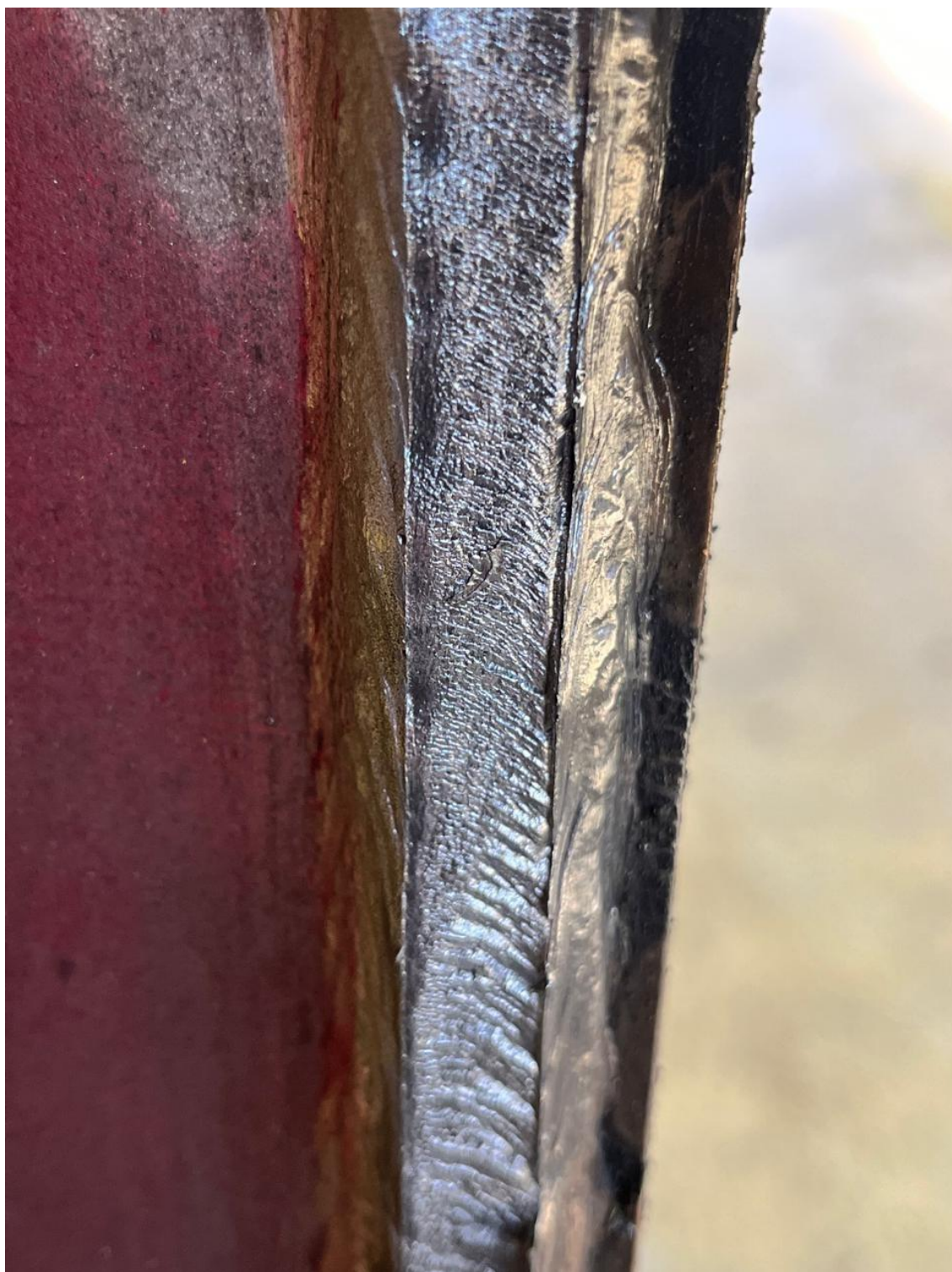
Propagação das fissuras – característica de fadiga
