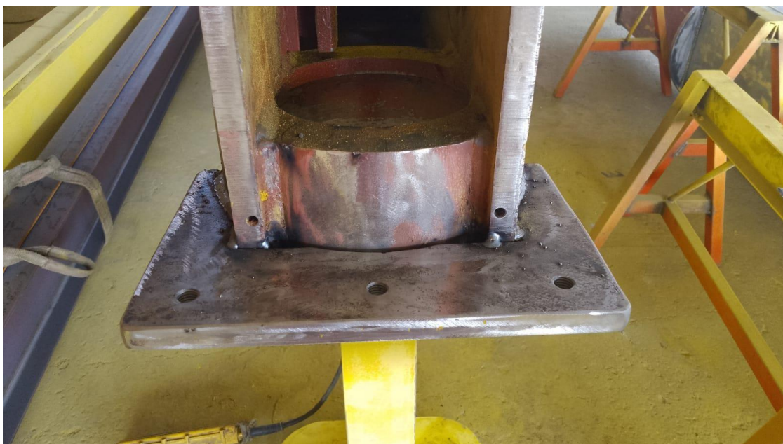
Chapa adicionada no mancal do rolamento autocompensador
