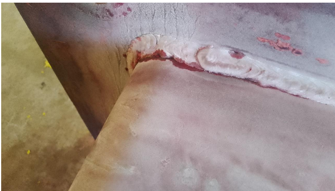
Trincas presentes nas bordas do cordão de solda
