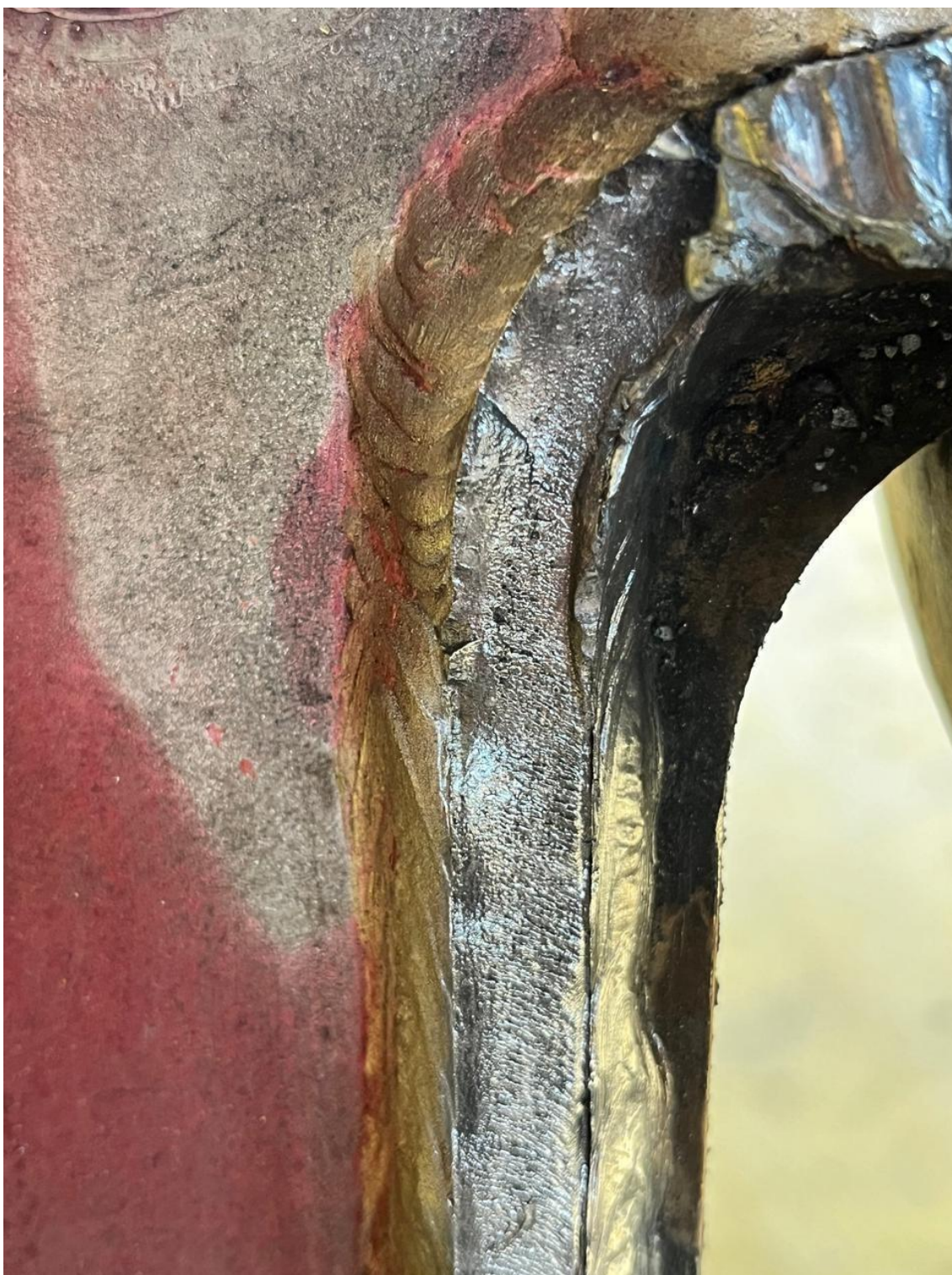
Propagação das fissuras – característica de fadiga
