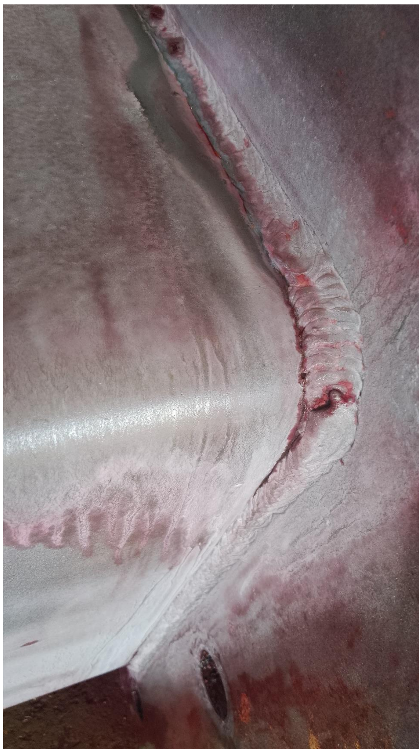
Trincas presentes nas bordas do cordão de solda
