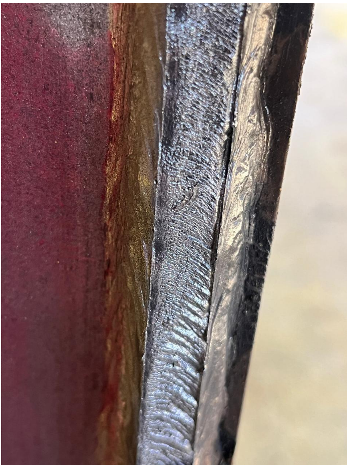
Propagação das fissuras – característica de fadiga
