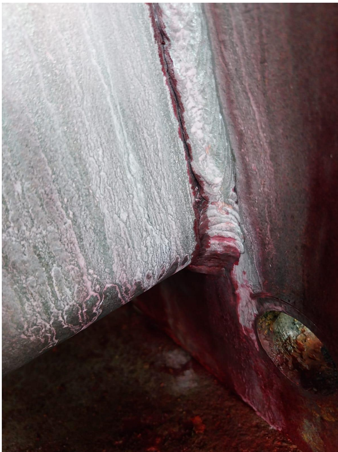
Trincas presentes nas bordas do cordão de solda
