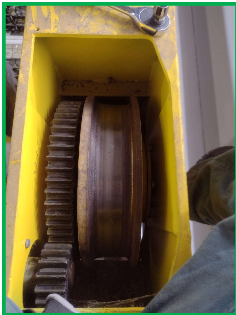
Roda tracionada de translação – Ponte Rolante 01
