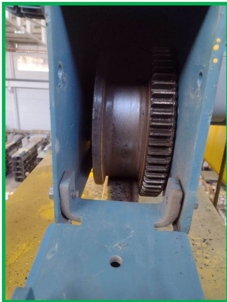
Roda tracionada de direção – Ponte Rolante 01
