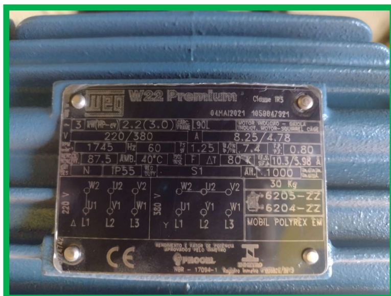
Placa de identificação do motor de translação – Ponte Rolante 02
