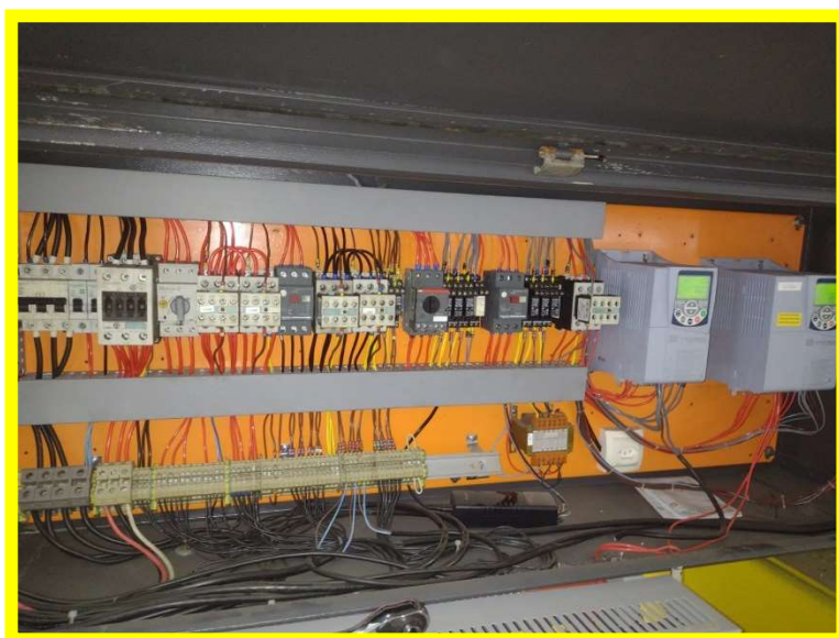
Quadro de comando – Ponte Rolante 01
