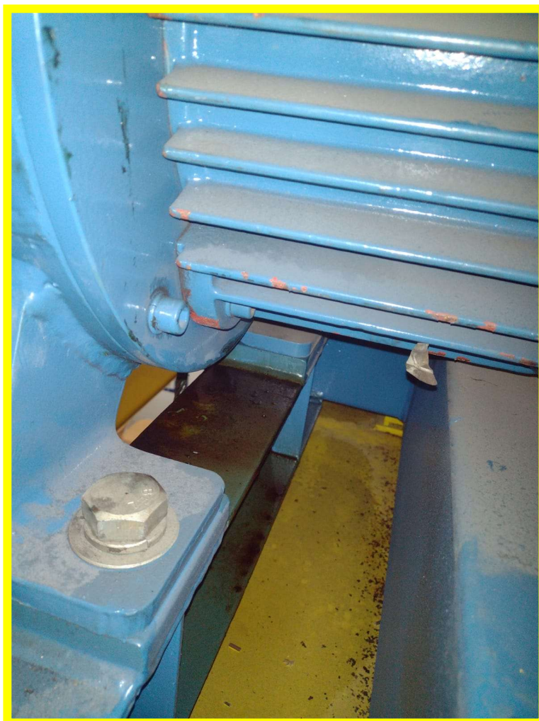
Vazamento de graxa na talha – Ponte Rolante 01
