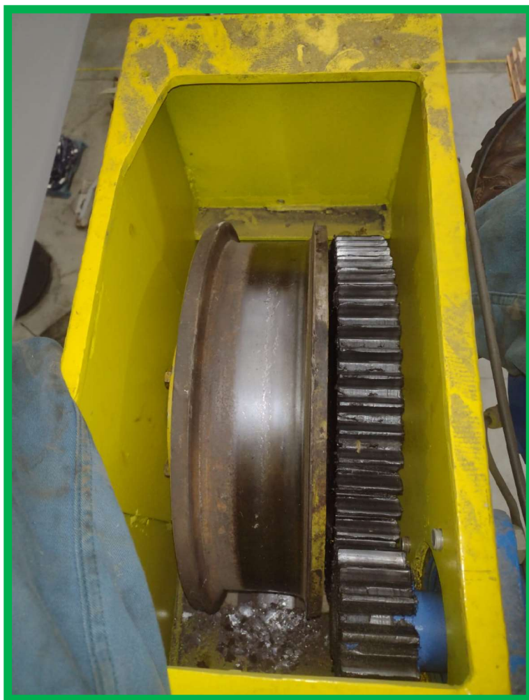
Roda tracionada de translação – Ponte Rolante 01
