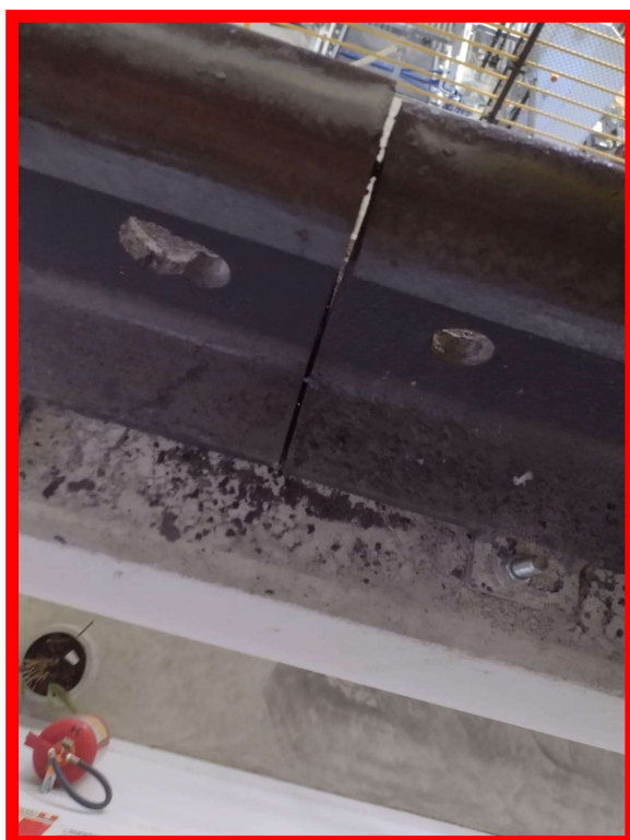
Trilho de rolamento desnivelado– Ponte Rolante 02
