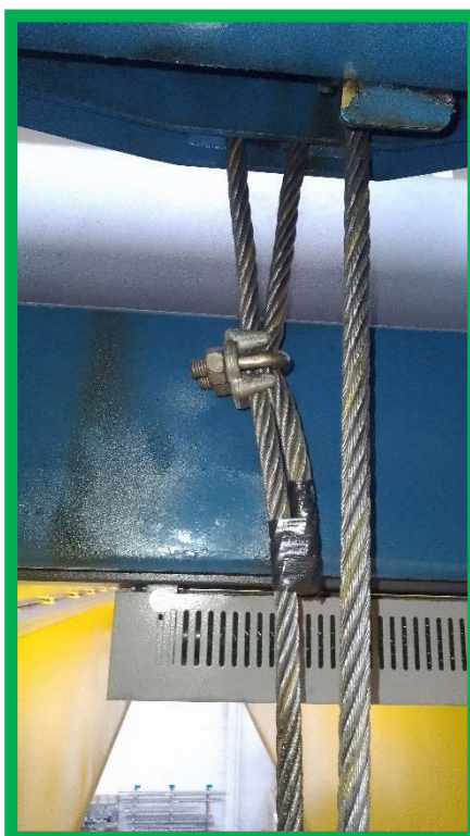
Ponto fixo – Ponte Rolante 01
