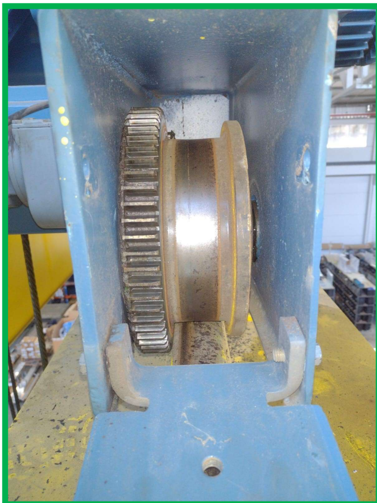
Roda tracionada de direção – Ponte Rolante 01
