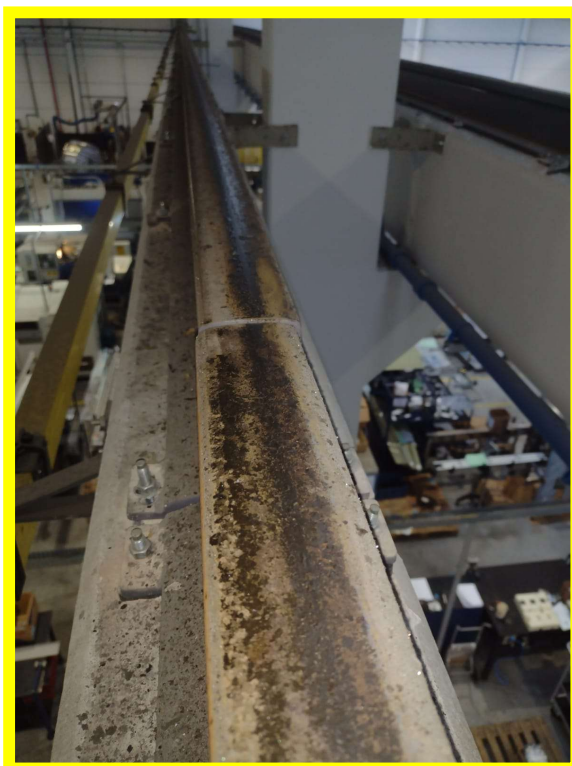
Trilho de rolamento desalinhado – Ponte Rolante 02
