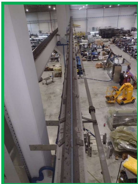
Trilho de rolamento alinhado – Ponte Rolante 01
