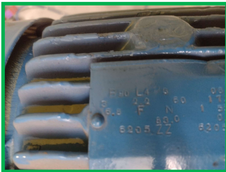
Placa de identificação do motor de translação – Ponte Rolante 01
