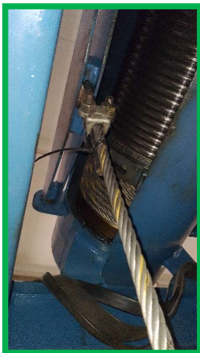
Ponto fixo – Ponte Rolante 02
