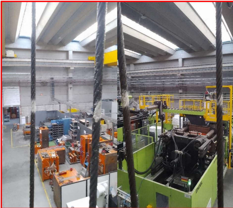
Cabo de aço – Posição 3 (-8,91%) - Ponte Rolante 10 TON.
