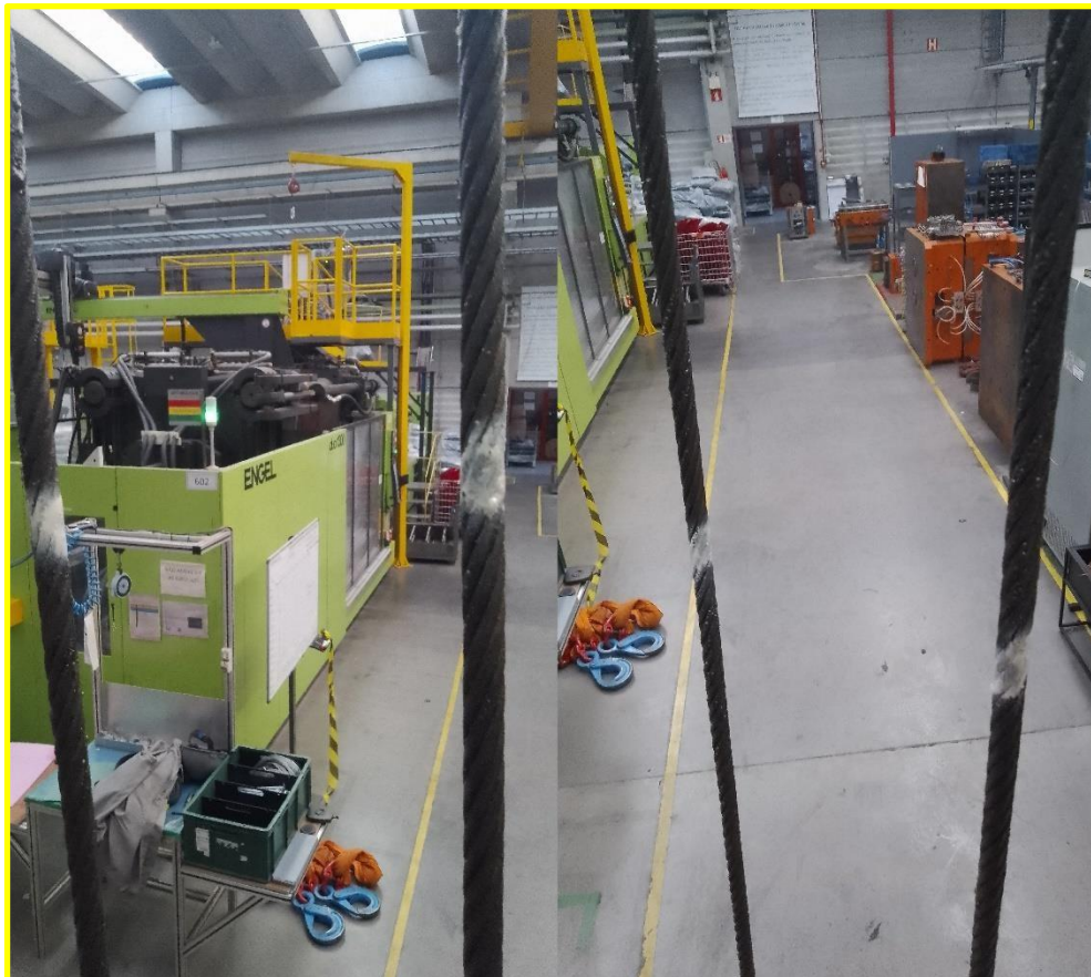
Cabo de aço – Posição 6 (-4,81%) - Ponte Rolante 10 TON.
