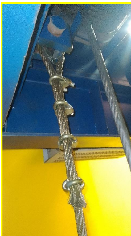
Ponto Fixo - Ponte Rolante 23 TON.
