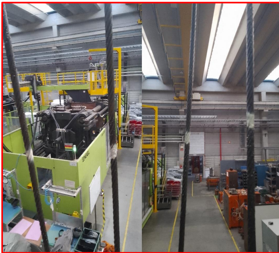
Cabo de aço – Posição 4 (-8,03%) - Ponte Rolante 10 TON.
