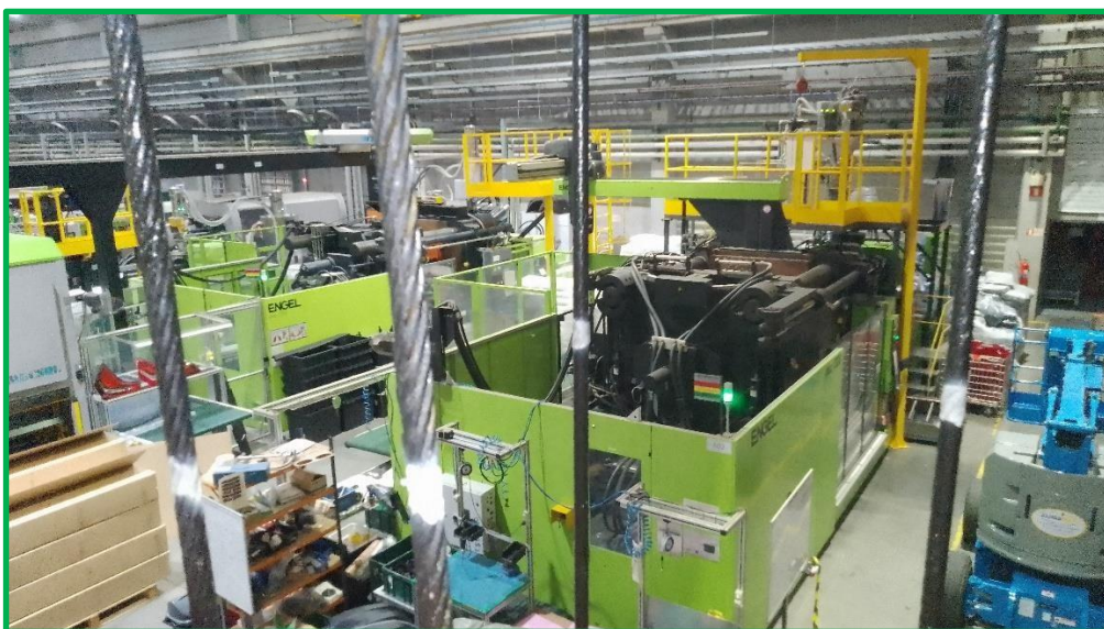
Cabo de aço – Posição 5 (-3,05%) - Ponte Rolante 23 TON.
