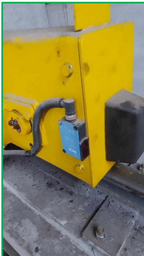
Anticolisão – 2m - Ponte Rolante 10 TON.
