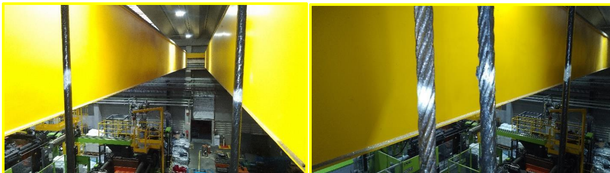
Cabo de aço – Posição 1 (-5,05%) - Ponte Rolante 23 TON.
