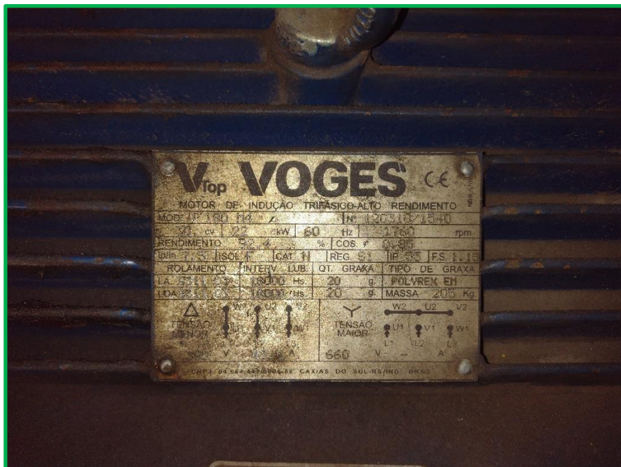
Placa de identificação – Motor do tambor de elevação - Ponte Rolante 23 TON.
