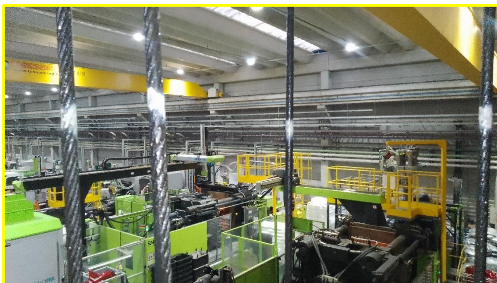
Cabo de aço - Posição 3 (-4,68%) - Ponte Rolante 23 TON.
