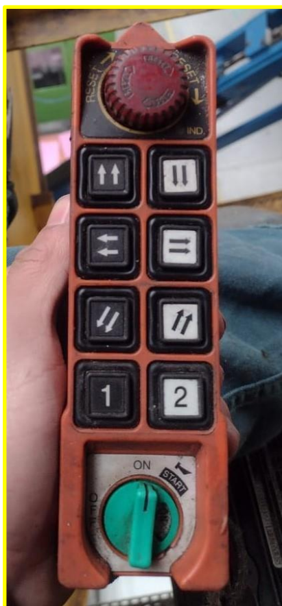
Controle de acionamento - Ponte Rolante 23 TON.
