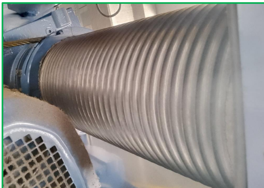
Tambor de levantamento - Ponte Rolante 10 TON.
