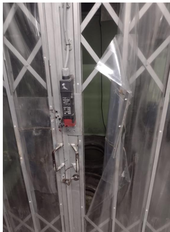
Grade de proteção danificada – 1º andar
