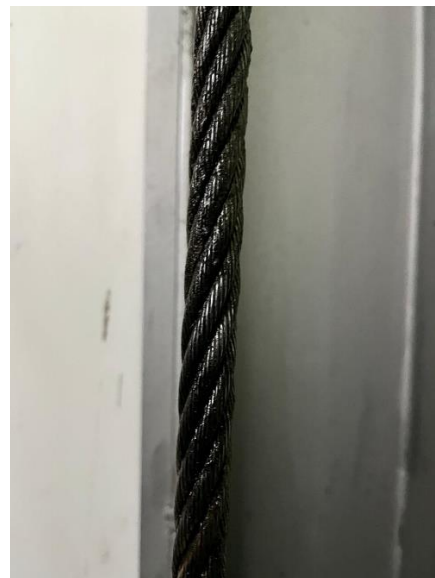
1m - Elevador 1º andar
