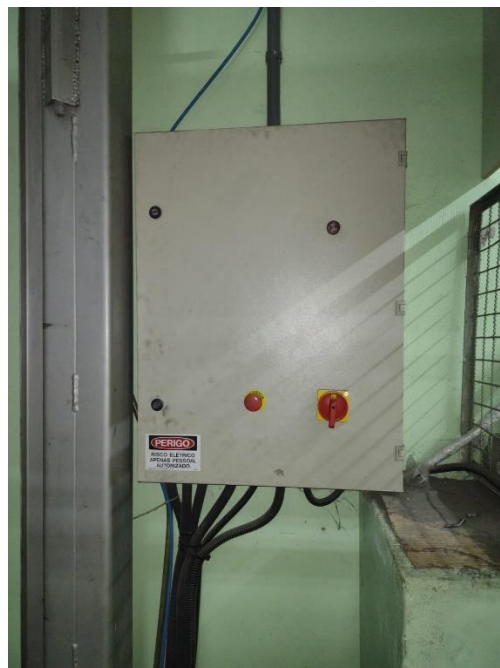
Quadro elétrico de comando
