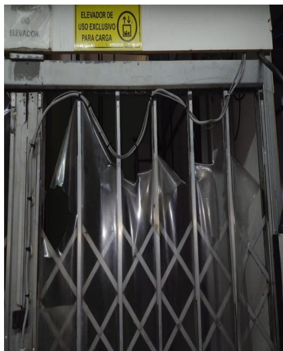
Grade de proteção danificada – 2º andar
