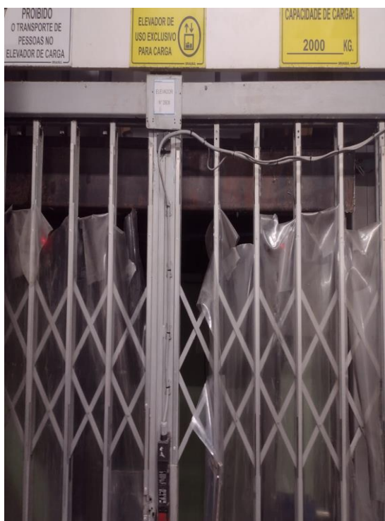
Grade de proteção danificada – 1º andar
