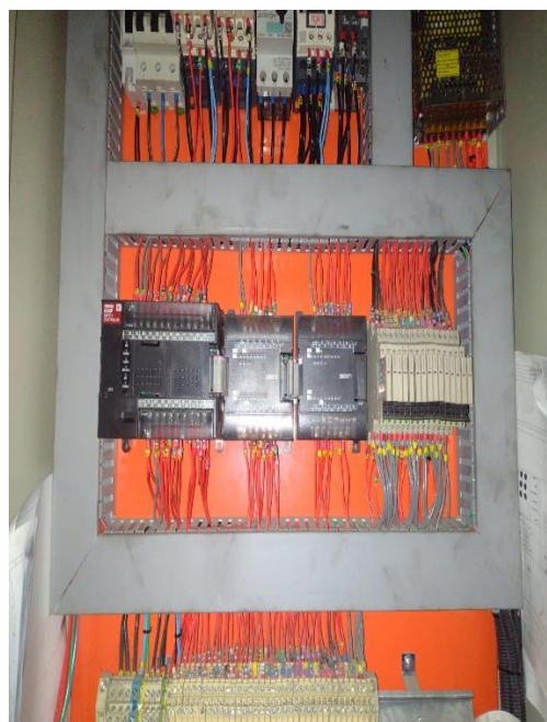
Quadro elétrico de comando – imagem3
