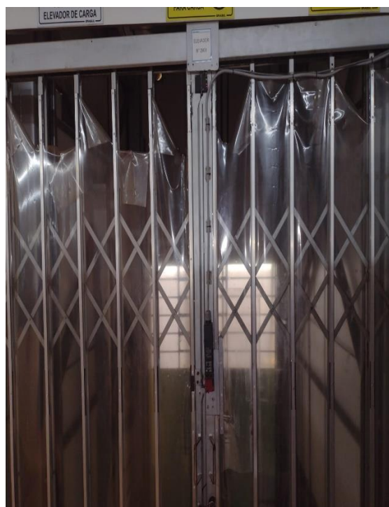
Grade de proteção danificada – 3º andar
