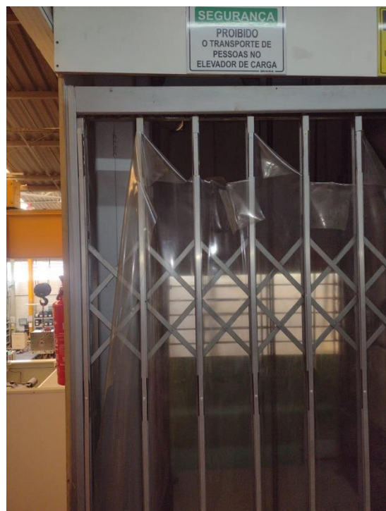
Grade de proteção danificada – 3º andar
