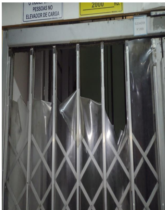
Grade de proteção danificada – 2º andar
