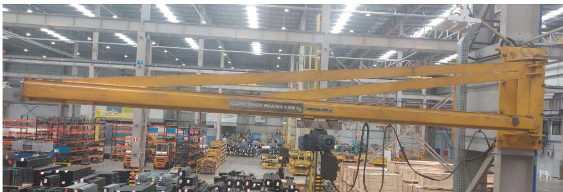
TALHA T13 COLUNA PAVILHÃO
