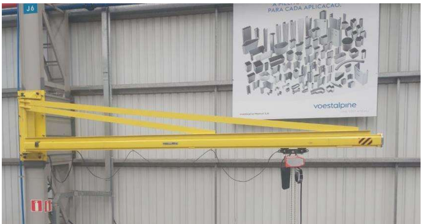
TALHA T12 COLUNA PAVILHÃO
