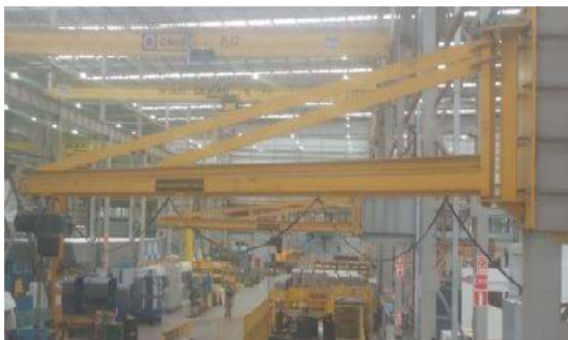
TALHA T05 COLUNA PAVILHÃO
