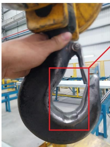
DEFORMAÇÃO CRÍTICA NO GANCHO DE LEVANTAMENTO PRINCIPAL
