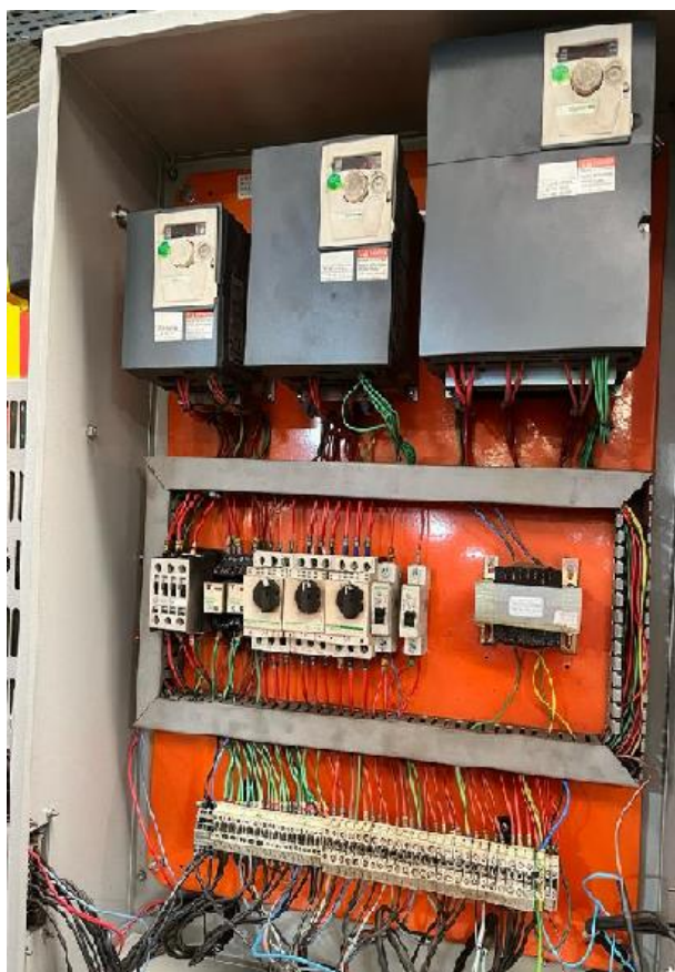
Caixa elétrica ponte rolante
